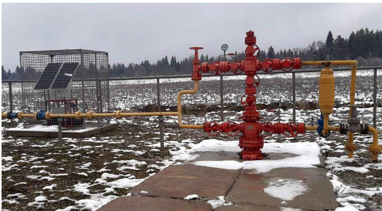
Рисунок 1.7 - Загальний вигляд АСП та фонтанної арматури свердловини
