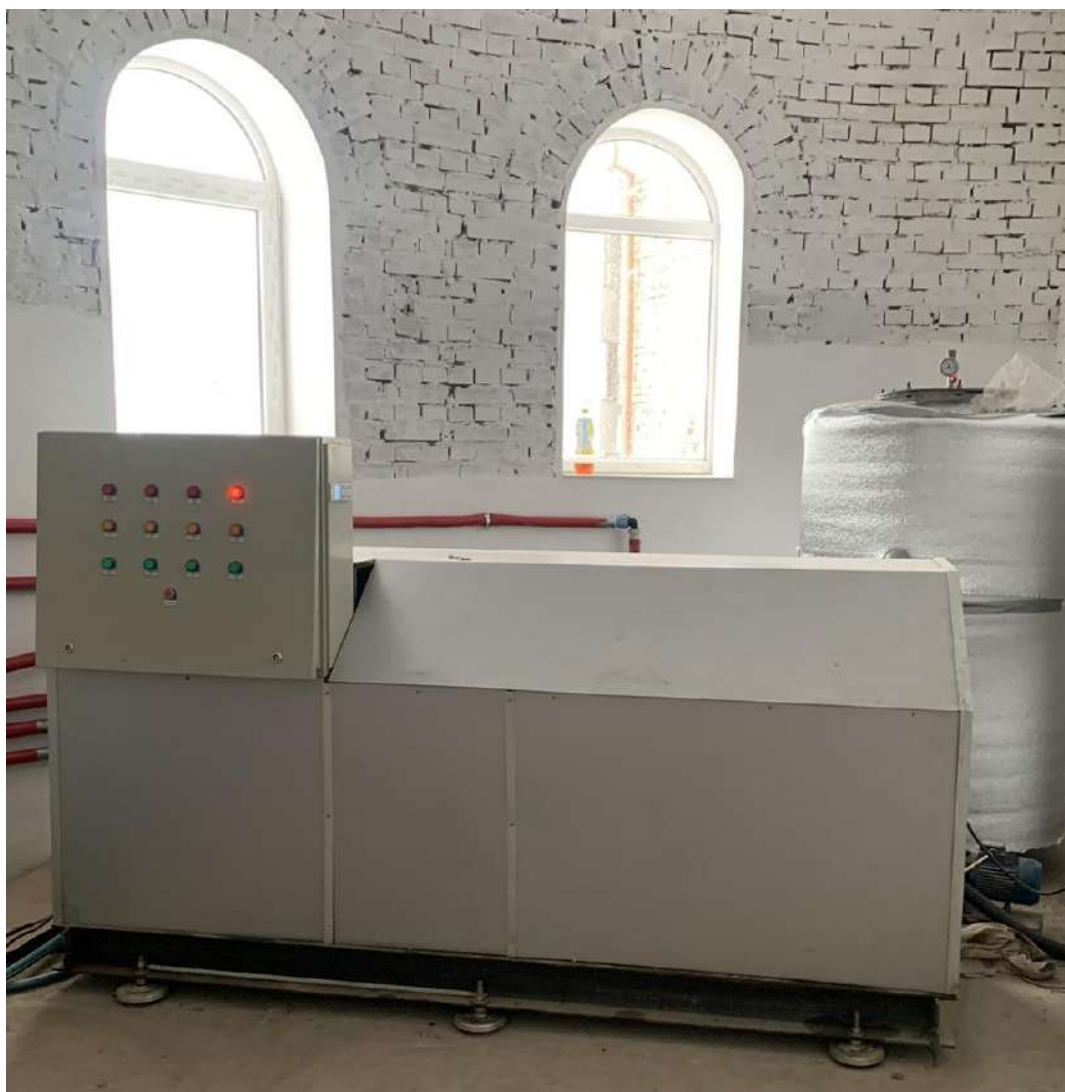
Тепловий насос готовий до експлуатації
