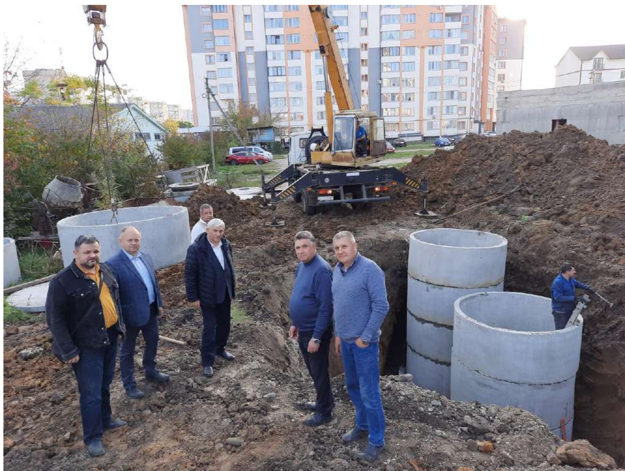
Активні учасники виконання будівельно-монтажних робіт: Настоятель Храму Володимира та Ольга о. Іван Яковлюк; ректор університету Крижанівський Євстахій Іванович; перший проректор, професор Мандрик Олег Миколайович; координатор проекту завідувач кафедри, професор Запухляк Василь Богданович
