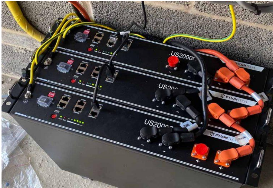
Рисунок 1 – АБ Pylontech US2000 з вмонтованим вогнегасником
