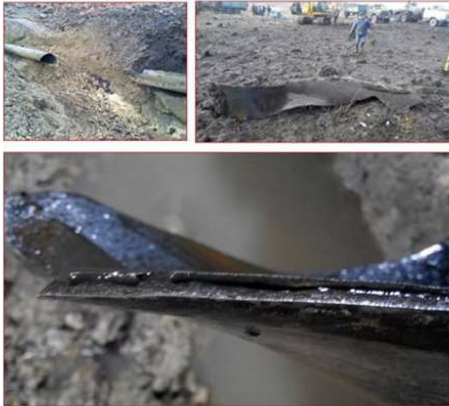
Рисунок 1.3 – Наслідки аварії на газопроводі спричинені витоками газу, магістральний газопровід «Комарно-Дроздовичі» Ду500 на 6 км.
