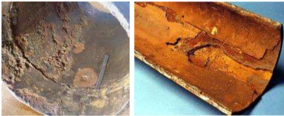
Рисунок 1.11 – Корозійні пошкодження внутрішньої поверхні газопроводу
