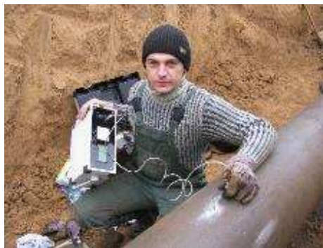
Рисунок 5.7 – Визначення фізико-механічних характеристик та виявлення дефектів в сталевих трубопроводах.
